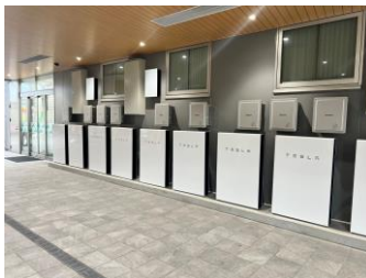
忠生支店蓄電池
