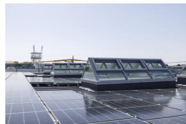
屋上ソーラーパネル
