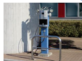
図 市庁舎設置普通充電器
