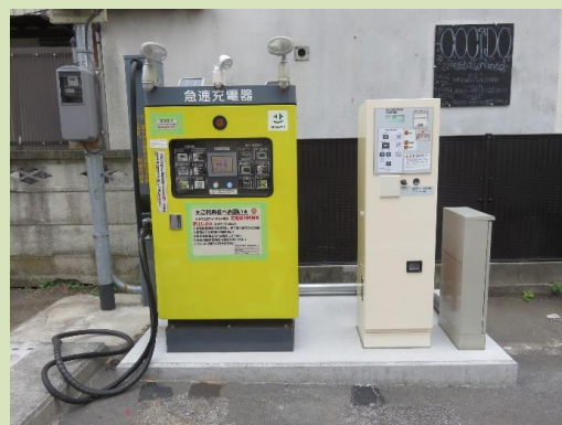
町田新産業創造センター設置の急速充電器
