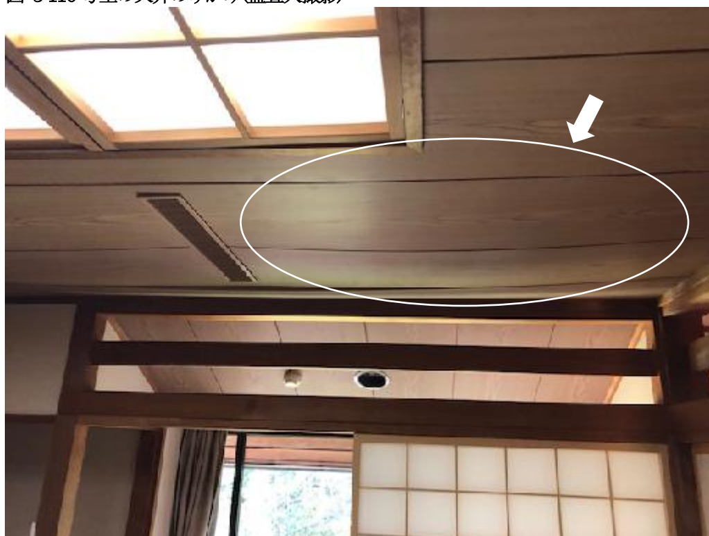
図 3 110 号室の天井のゆがみ(監査人撮影)
