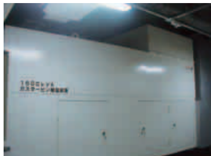
非常用自家発電設備
