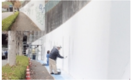
落書きだらけの壁面(写真左上)がきれいに生まれ変わりました
