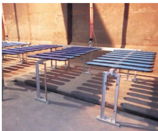
図6-1 成瀬クリーンセンターの高効率散気装置
