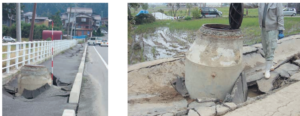
図6-18 2004年10月の新潟県中越地震における液状化によるマンホール浮上状況 (写真：新潟県小千谷市提供)
