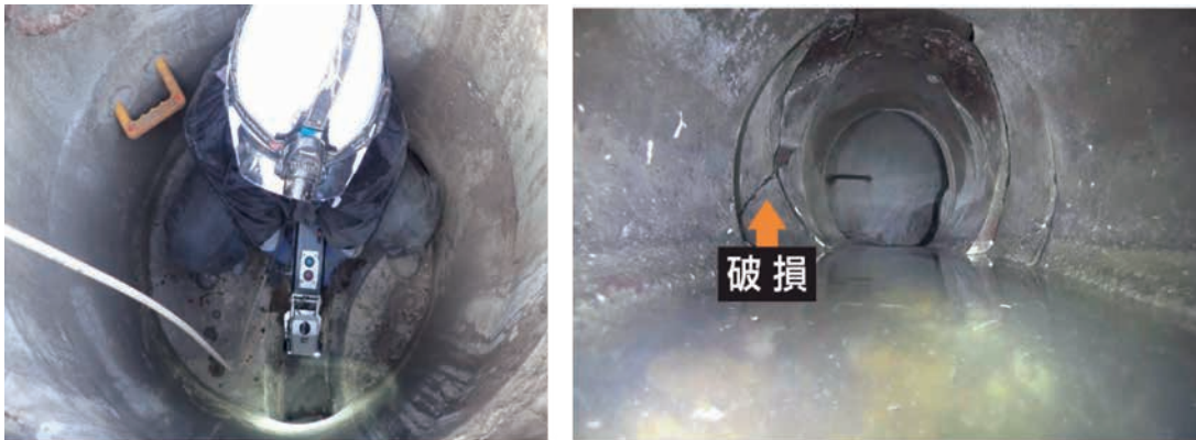
図6-23 スクリーニング調査の状況（左）、破損状況のイメージ（右）
