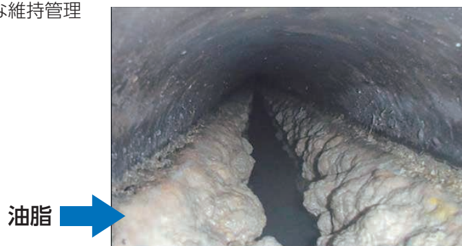
図6-3 油脂がたまった下水道管の内部
