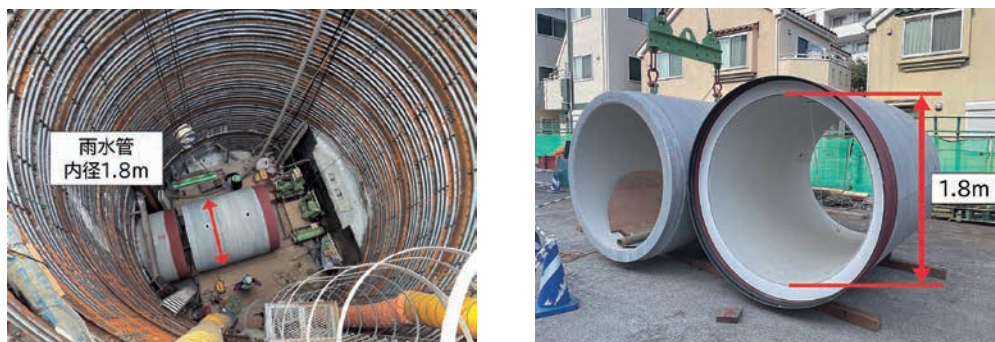
(大口径推進管：内径1.8m) 図6-8 浸水対策として行う雨水管整備工事
