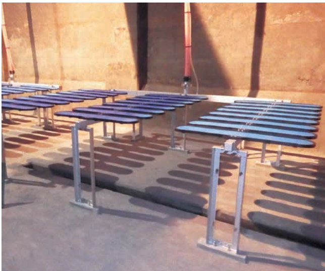
図6-4 成瀬クリーンセンターの高効率散気装置
