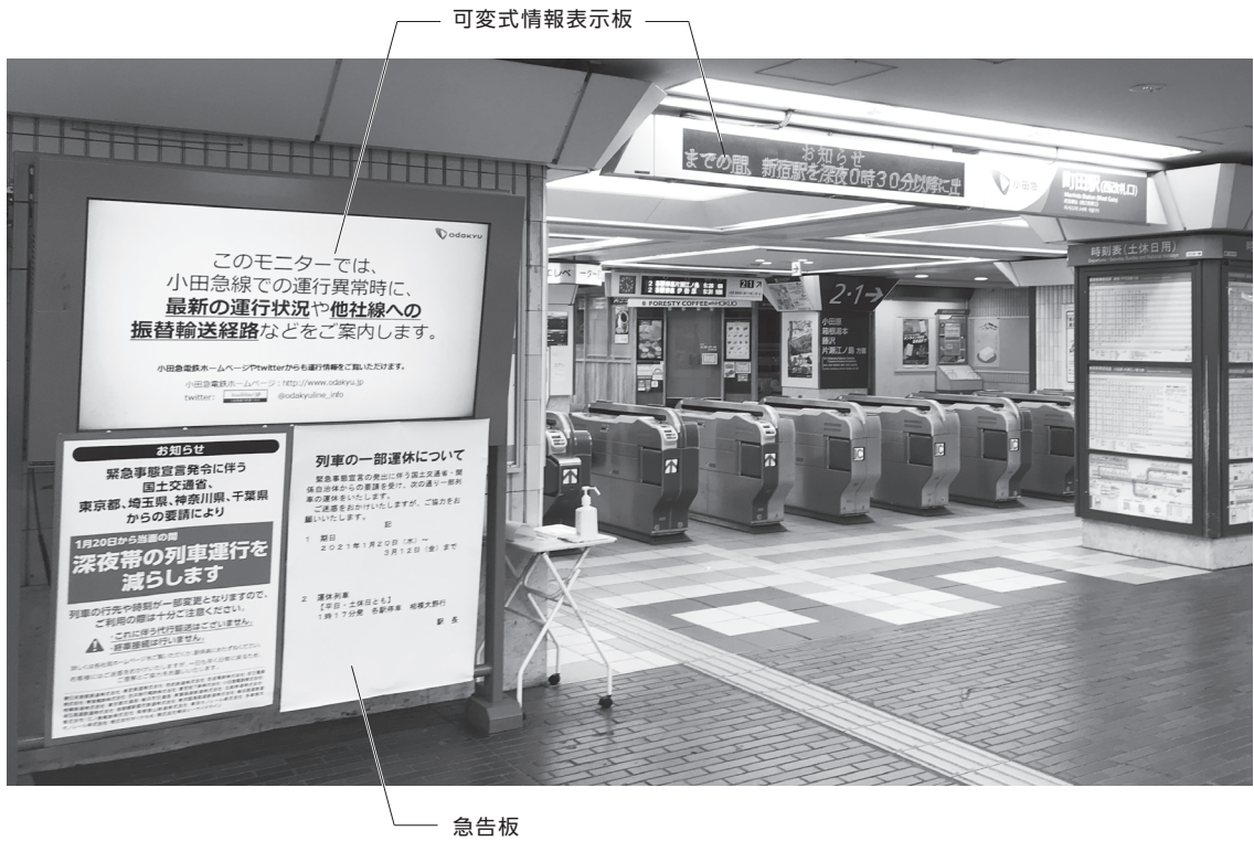
【写真14.2】 可変式情報表示板の配置例
