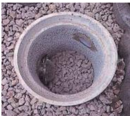
雨水浸透ます
