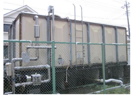
<南中学校学校給水設備>
