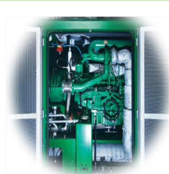
バイオガス発電機
