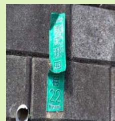
街区表示板の不具合
