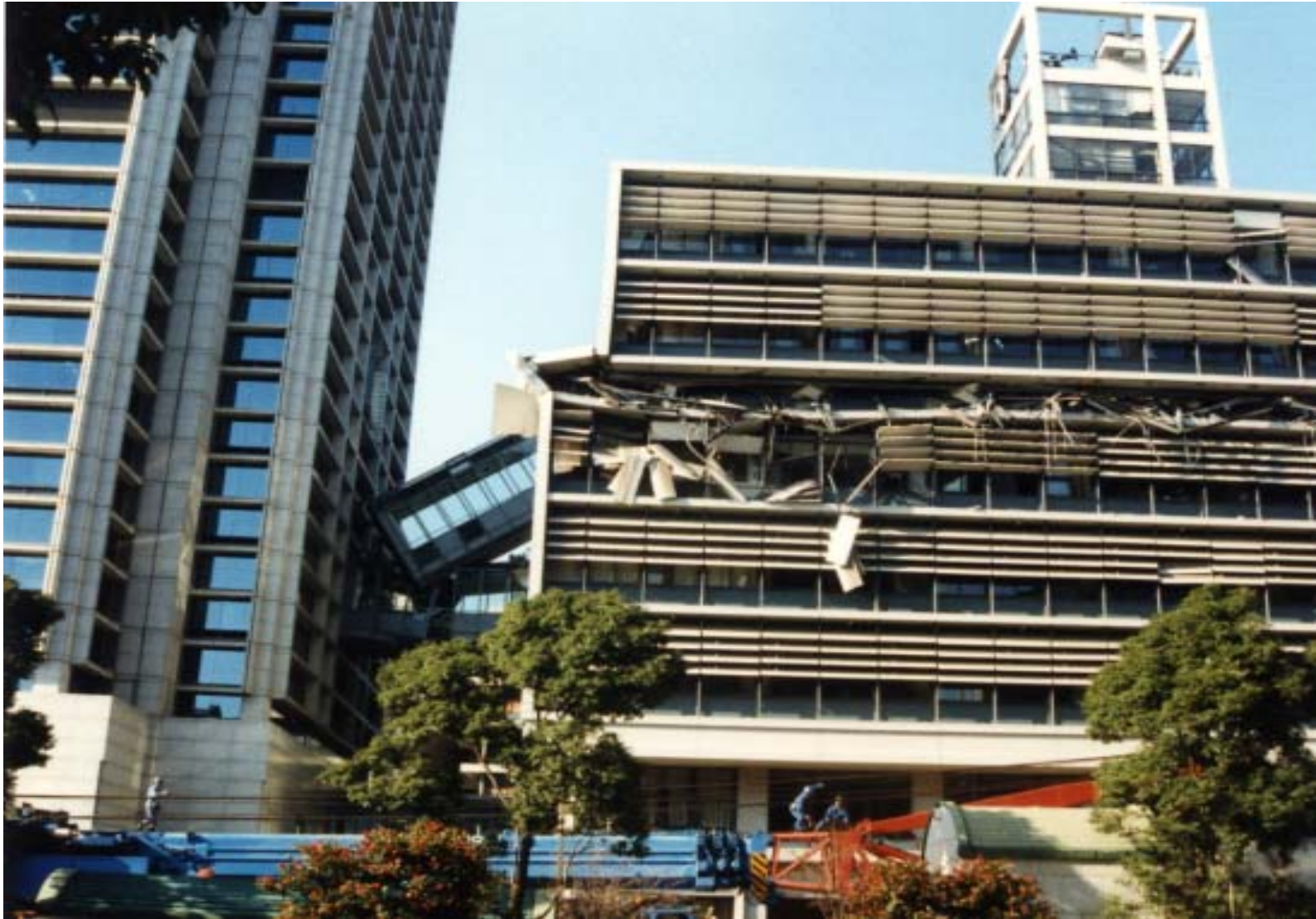
阪神・淡路大地震における神戸市役所の被害状況
