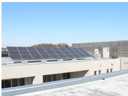
函師小学校に設置した 太陽光発電システム
