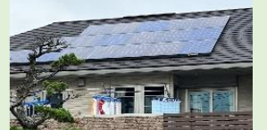
戸建住宅のソーラーパネル
