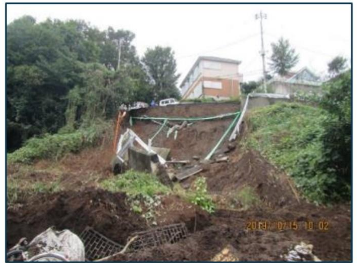
《がけ崩れの様子》
