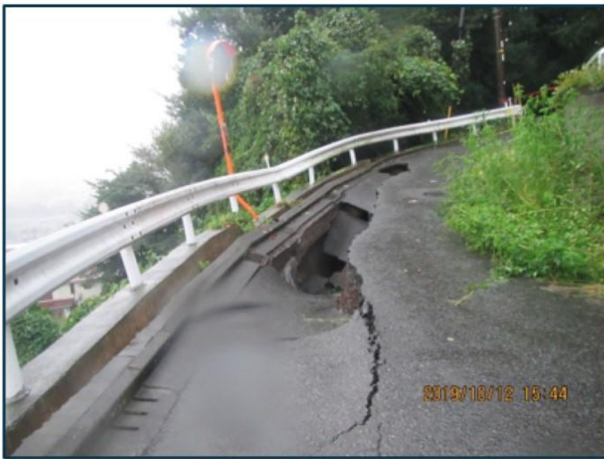
《道路破損の様子》
