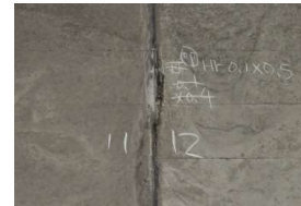
アーチ部の剥落
