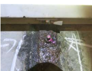
継手部からの漏水
