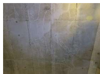
頂版のひびわれ
