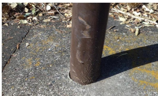
(施工前) 根入れ部で劣化（防食機能）した鋼管柱
