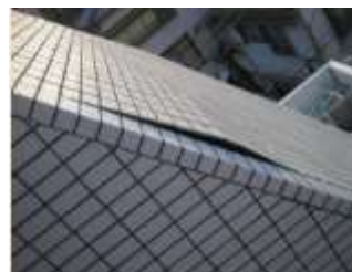
タイル面の浮き
