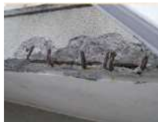
欠損による鉄筋の露出
