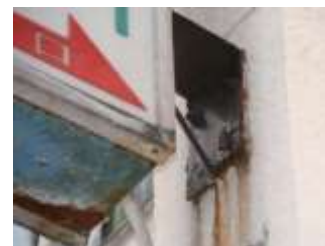
支持金具の腐食
