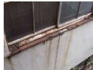
サッシの腐食
