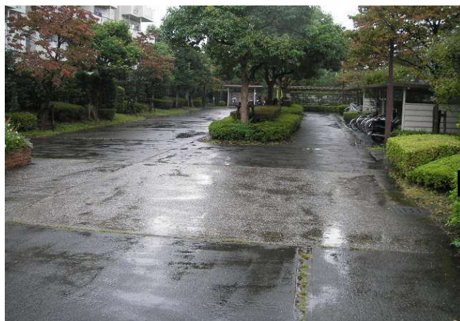
改修前のコンクリート舗装
