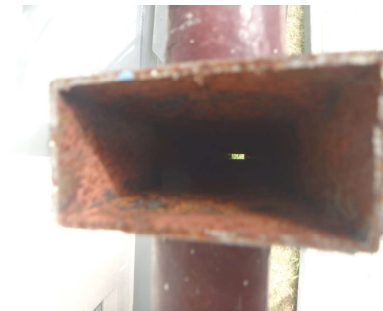
支柱内部の腐食
