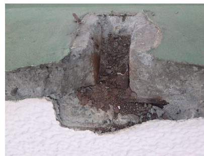
埋込部ベースプレート腐食
