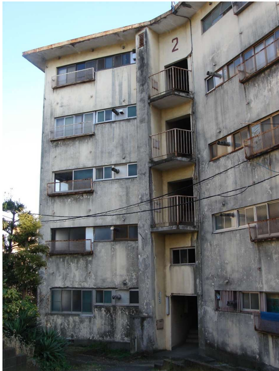
汚れ、ひびわれ、鉄筋露出が随所に見られる
