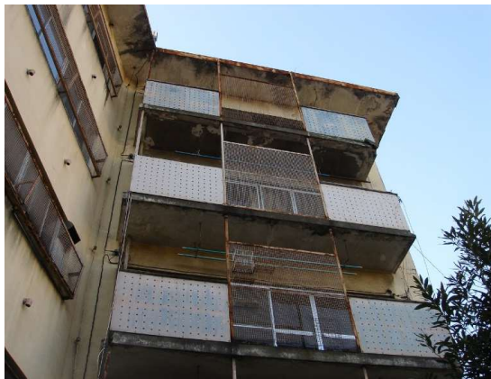
バルコニー天井・大底の劣化が著しい
