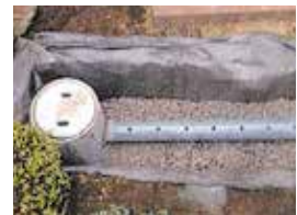
浸透トレンチ (写真提供・東京都下水道局)
