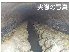
実際の写真 ラード(油脂分)が詰まった下水道管
