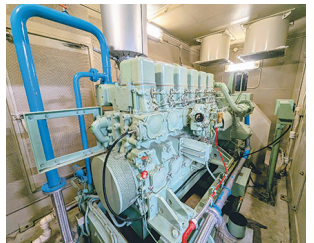
非常用発電設備
