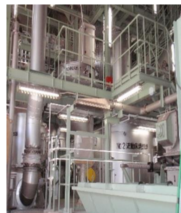
図5. 高温焼却対応型焼却炉 (成瀬クリーンセンター)
