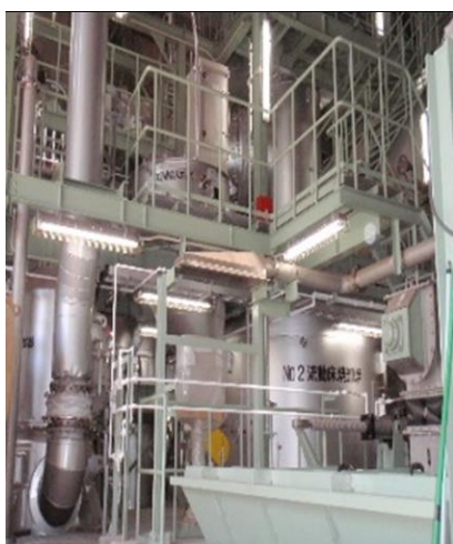
図3 高温焼却対応型焼却炉
