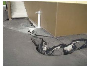
下水処理場の被災
