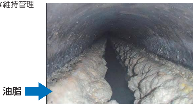
図6-3 油脂がたまった下水道管の内部
