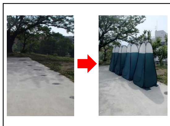
図 6-20 マンホールトイレ設置の様子（写真）
