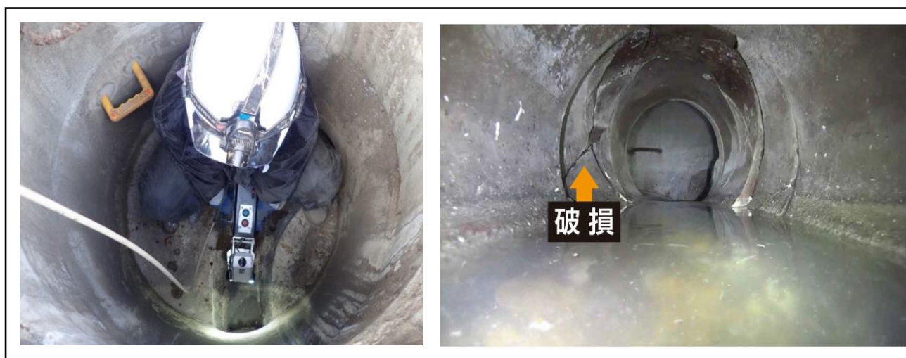
図 6-22 スクリーニング調査の状況（写真左）及び破損状況のイメージ（写真右）
