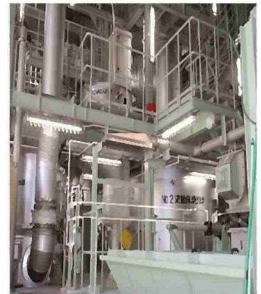
図 5. 高温焼却対応型焼却炉 (成瀬クリーンセンター)
