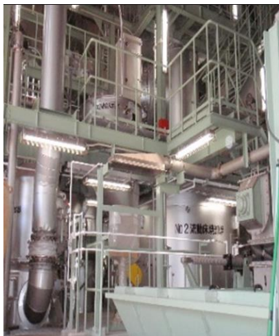
図3 高温焼却対応型焼却炉
