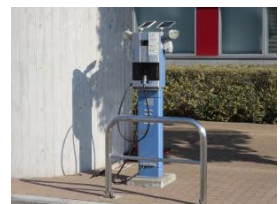
図 市庁舎設置普通充電器 出典：町田市
