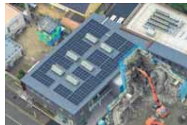
上空から見た屋上ソーラーパネル
