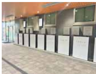
忠生支店蓄電池
