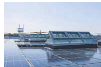
屋上ソーラーパネル
