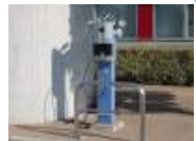
図 市庁舎設置普通充電器
