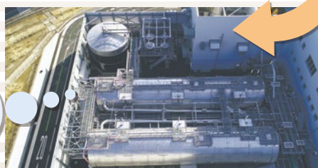
町田市バイオエネルギーセンター内 バイオガス化施設(発酵槽)
