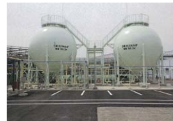
中圧ガスタンク
