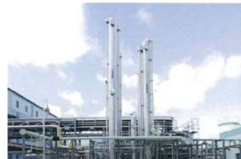
バイオガス天然ガス化装置
