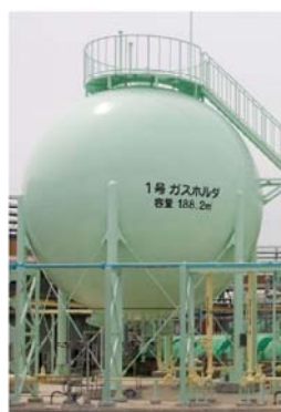
1号 ガスホルダ 容量 188.2m³ 精製・中圧貯留: φ 7.1m × 9.2mH (188.2m³)
