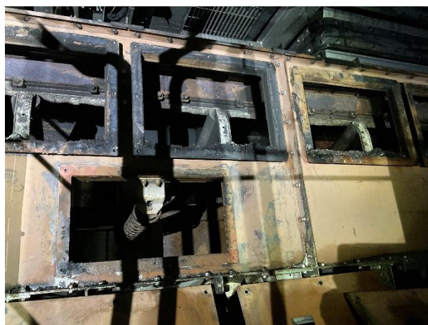
写真 2 選別ごみ搬送コンベヤの焼損状況
