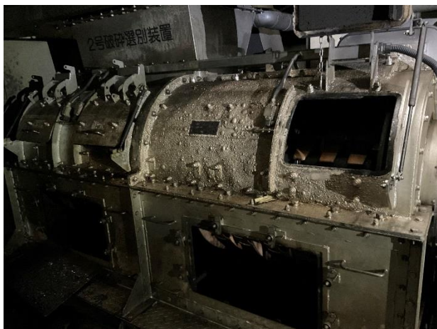
写真 1 破碎選別装置の焼損状況
