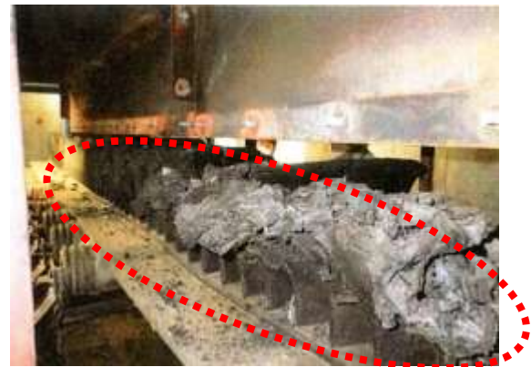
写真2 コンベヤ損傷状況②
