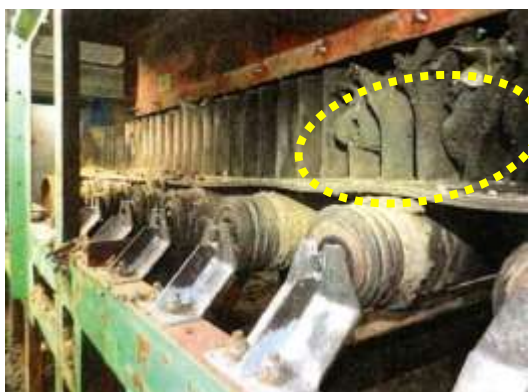
写真1 コンベヤ損傷状況①
