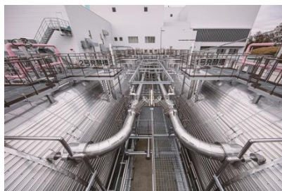
（町田市バイオエネルギーセンターバイオガス化施設の発酵槽）
