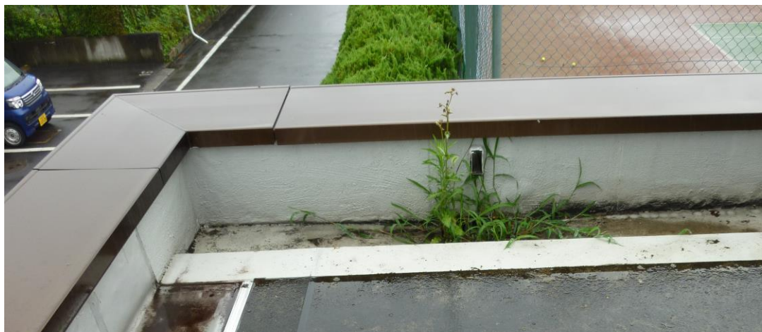
屋上の排水ドレインに泥が溜まり、草が生えている事例
