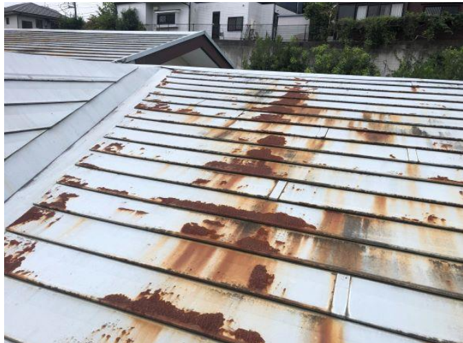
鉄板の屋根 錆が発生している例
