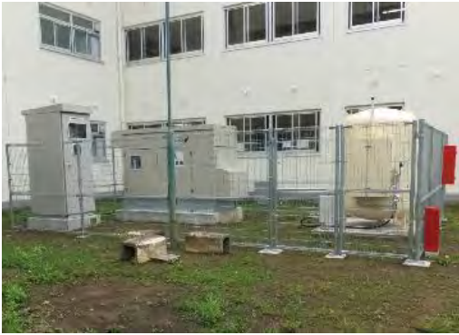
既存発電設備
