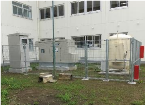
既存発電設備
