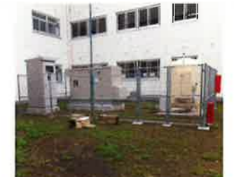
既存発電設備
