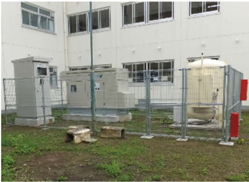
既存発電設備
