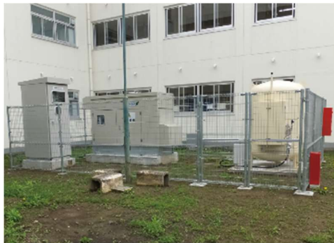
既存発電設備
