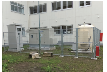
既存発電設備
