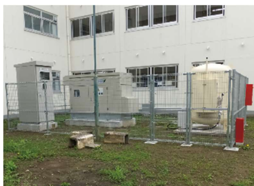
既存発電設備
