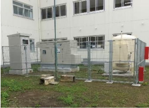
既存発電設備
