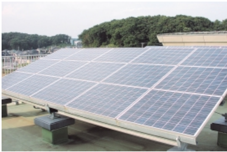
小山ヶ丘小学校屋上に設置されている太陽光発電モジュール
